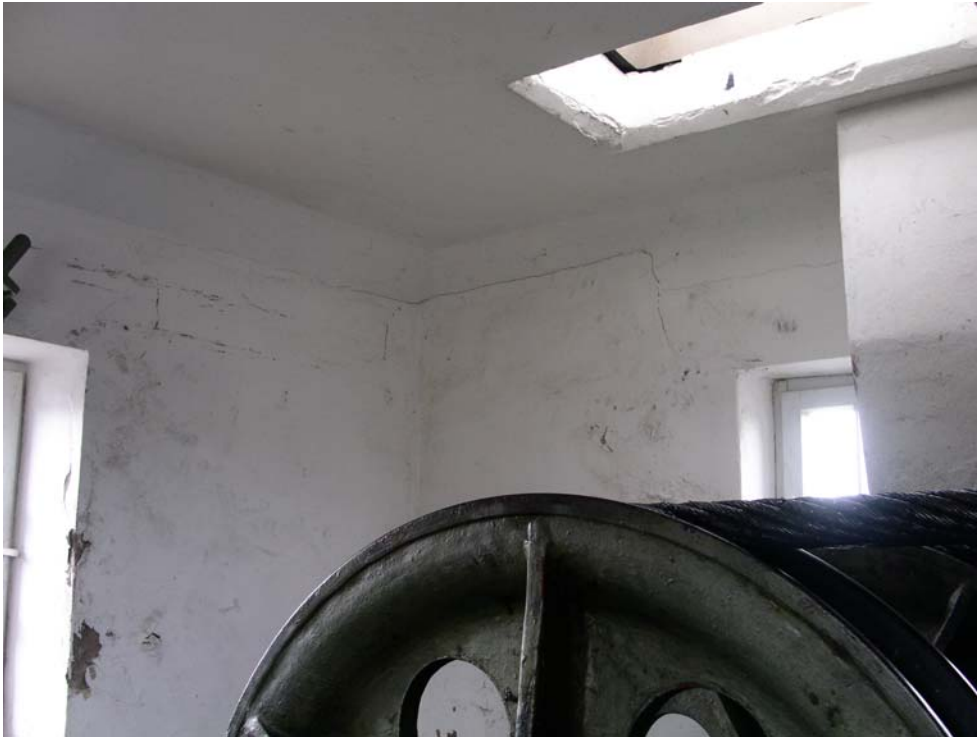
Bild 18: Antriebsraum, horizontale Risse zwischen MW und Deckenplatte / Turm 4
