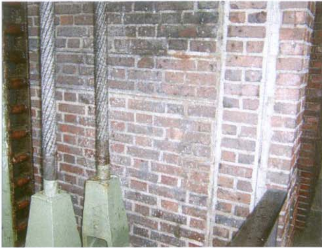
Bild 9 Turm 2: oberflächennahe Flansche von Profilstählen korrodieren lokal
