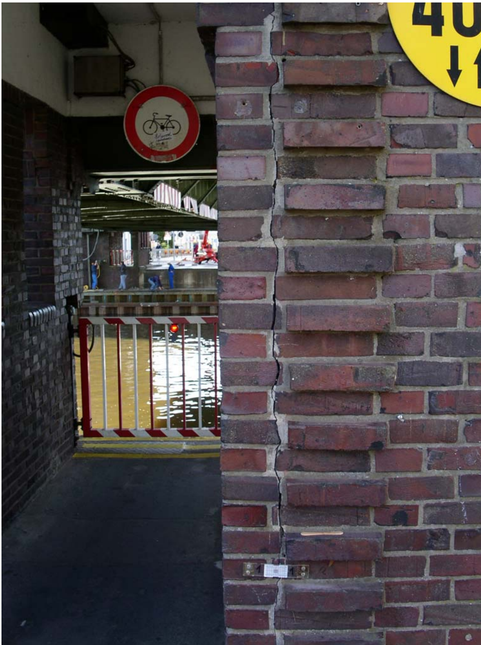
Bild 9: Vertikaler Riss im Mauerwerk / Turm 2
