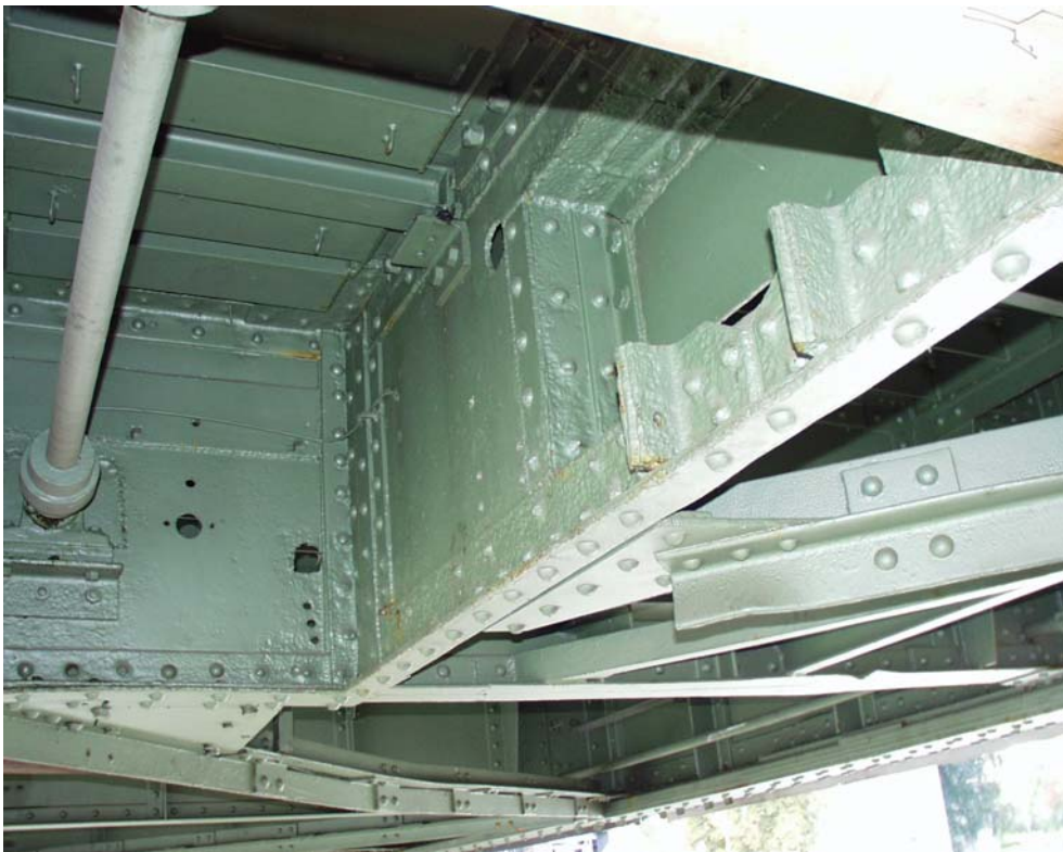
Bild 37: Unterbrochener Windverband, überschichtete Abrostungen
