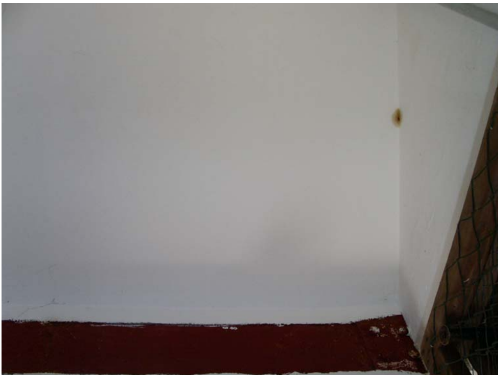
Bild 4: Rostfleck unter der Decke des Kellerraums / Turm 1
