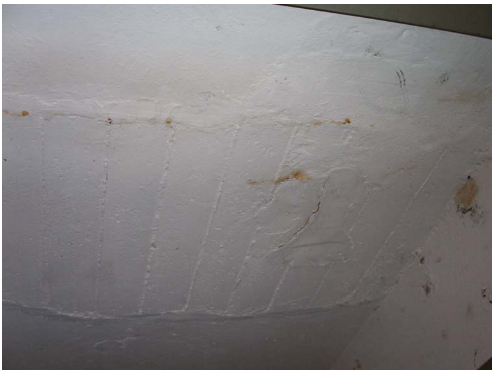
Bild 8: Putzabplatzungen mit Bewehrungskorrosion, Decke über dem Kellerraum / Turm 2
