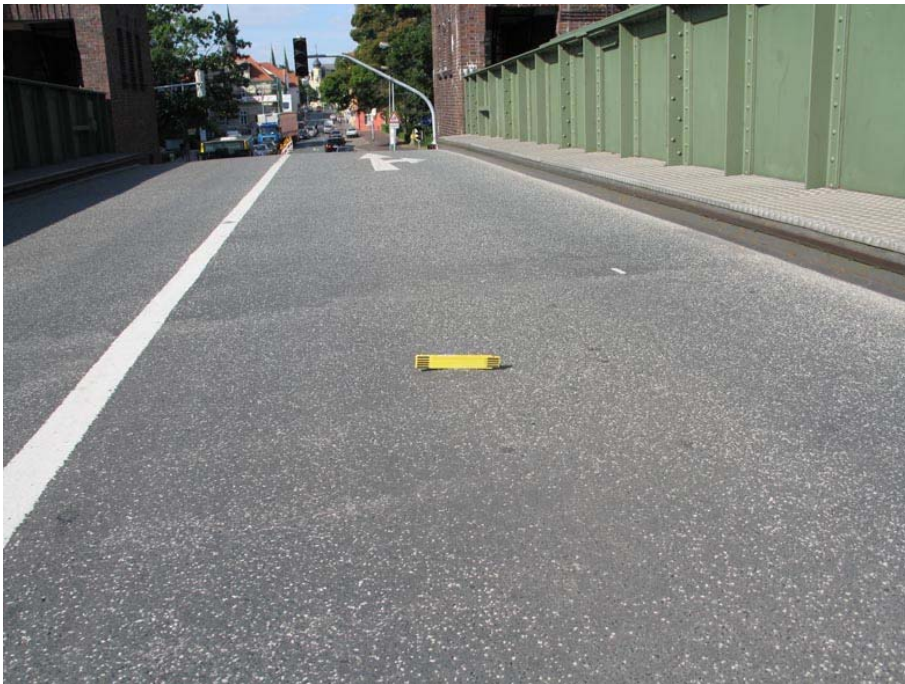
Bild 15: Dampfblase in Fahrbahn
