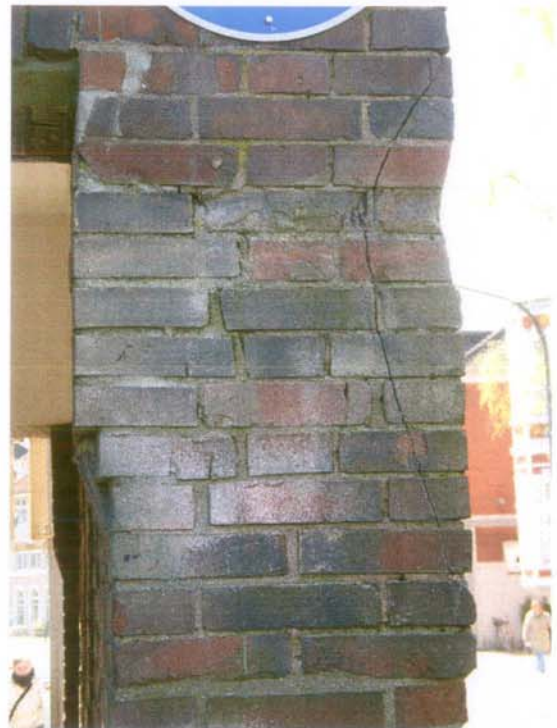
Bild 8 Risse/Verformungen infolge mechanischer Beschädigung
