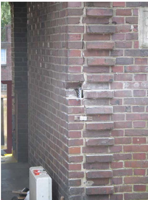
Bild 6: Turm 2 an Durchgang mit Erkundungsöffnung
