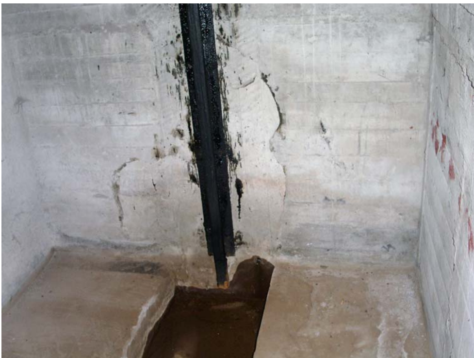
Bild 2: Schacht für die Gegengewichte / Turm 1
