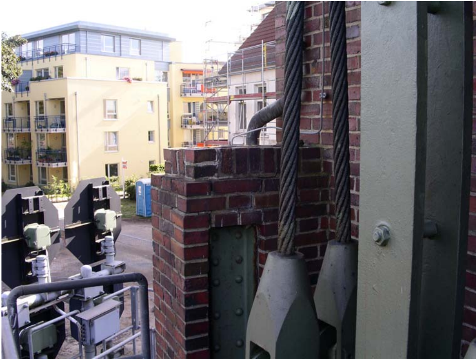
Bild 15: Brüchige Mörtelfugen im oberen Bereich der Mauerwerkskonsole / Turm 3
