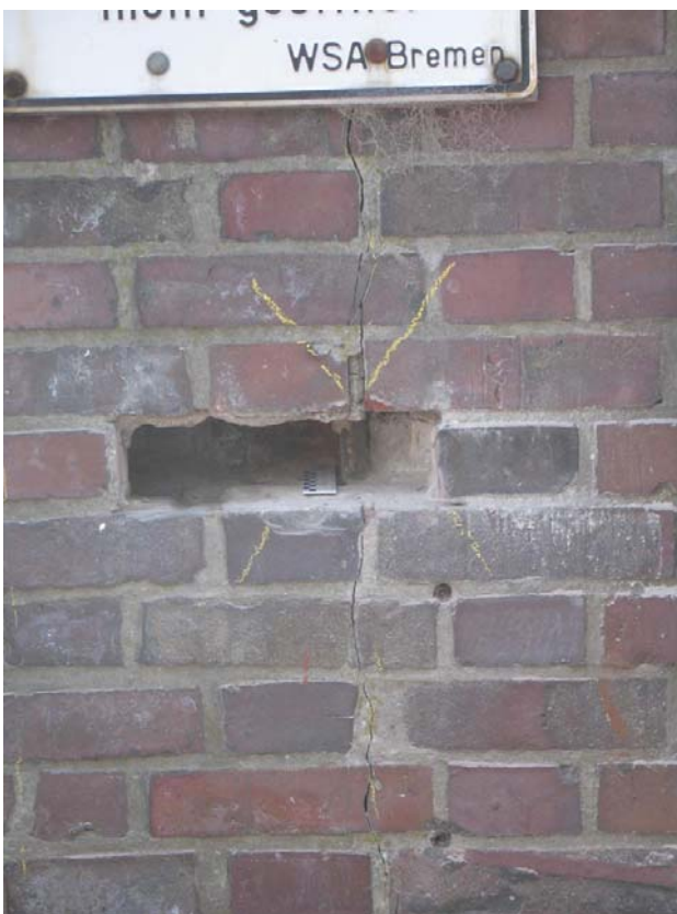
Bild 10: Detail Turm 2 am Treppenaufgang mit Erkundungsöffnung im Rissbereich
