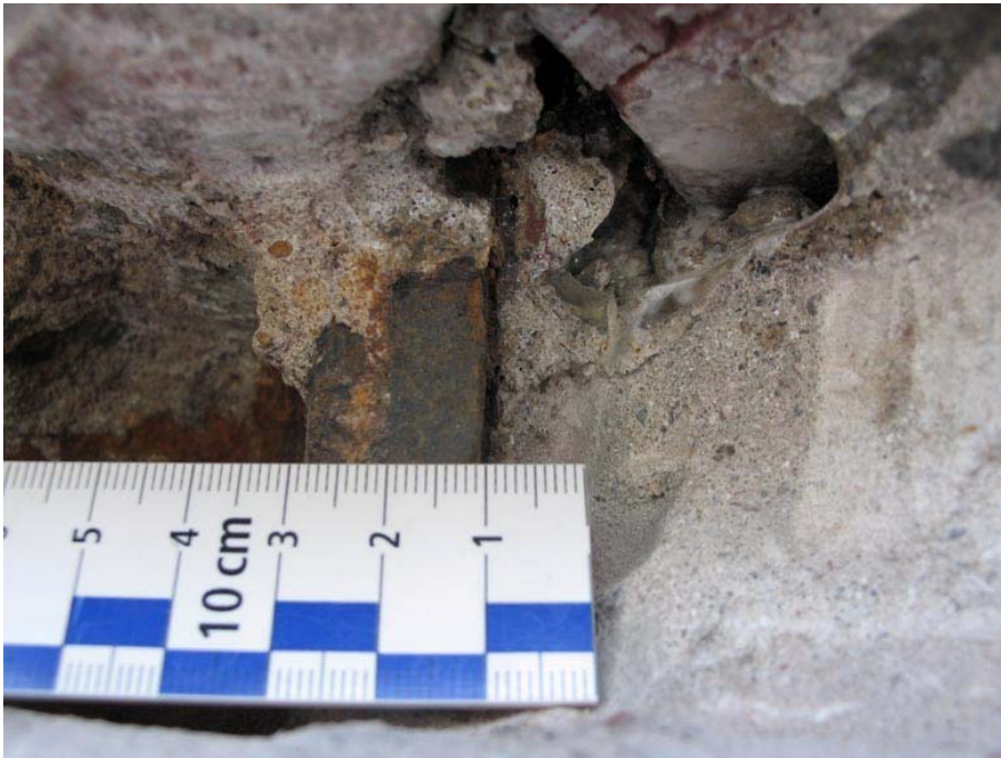
Bild 11: Rost auf Stahlträger von Hubgerüst am Turm 2
