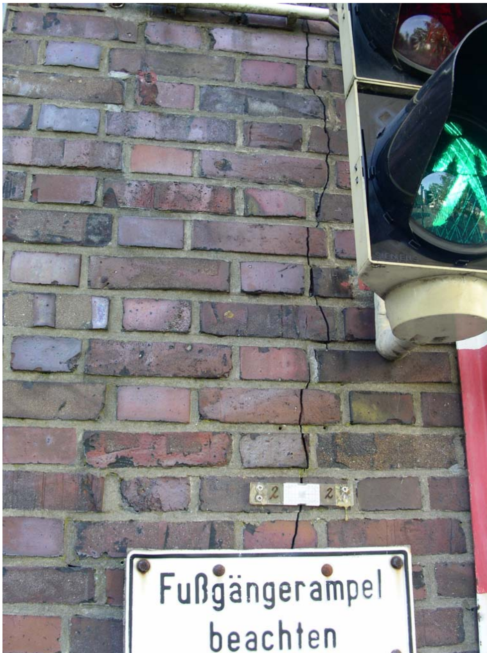
Bild 10: Vertikaler Riss der nord-westlichen Wand / Turm 2
