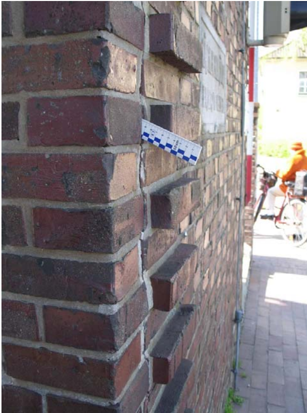
Bild 7: Riss an Durchgang von Turm 2
