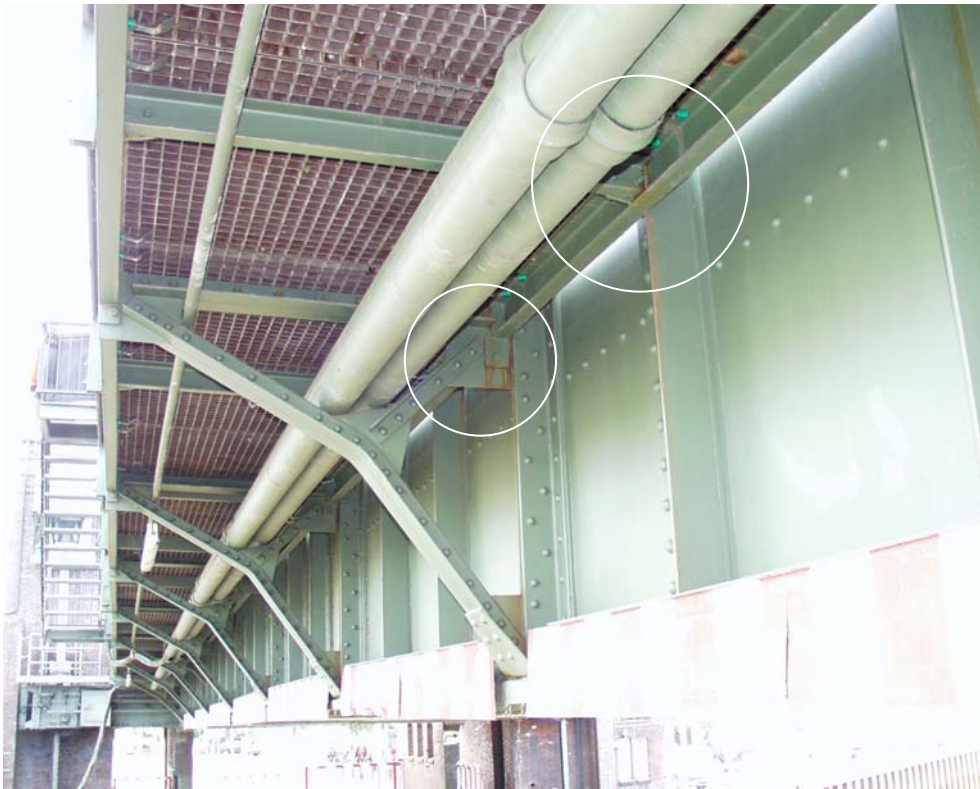
Bild 36: Beispiele für angerostete Anschlussbereiche der Fußstegkonsolen am HT-Steg
