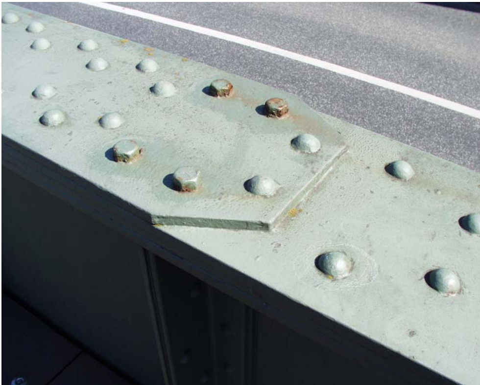
Bild 9: HT Westseite, Obergurt mit Nietersatz am Lamellenende
