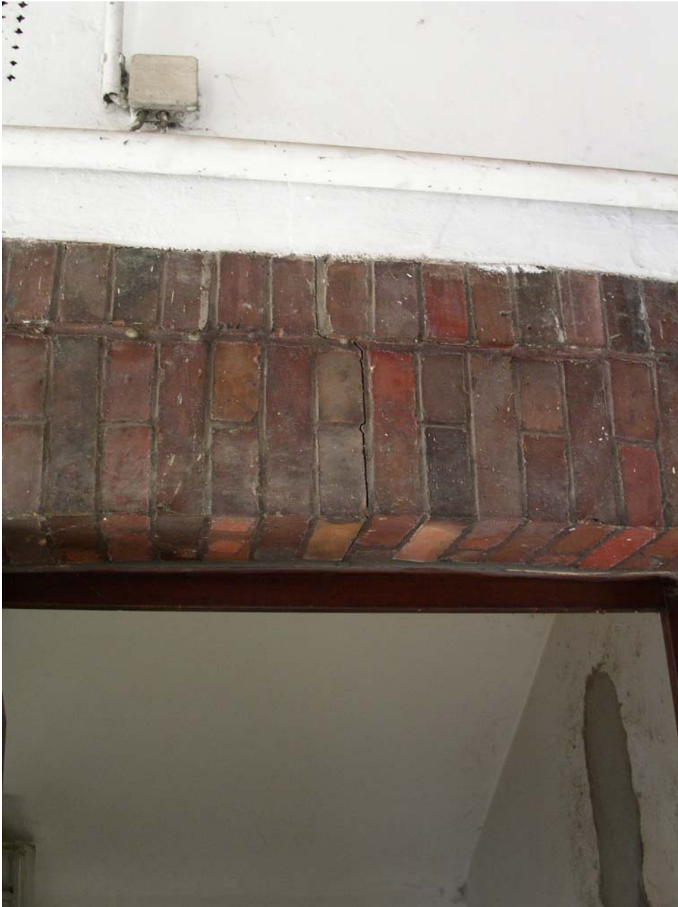
Bild 16: Vertikaler Riss über der Eingangstür / Turm 4
