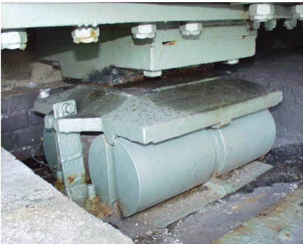
Bild 26: Brückenlagerung EQT Nordseite (Ober- und Unterteil bewegl. Lager)
