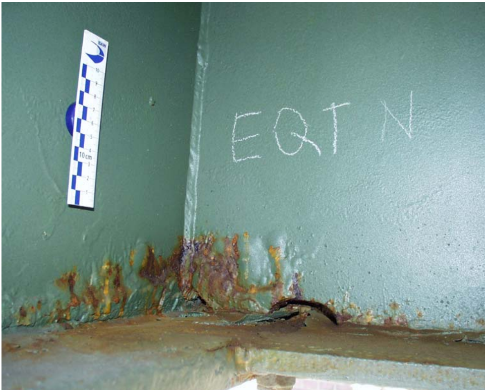
Bild 17: EQT-Nord (Abrostungen Untergurt-Bereich)
