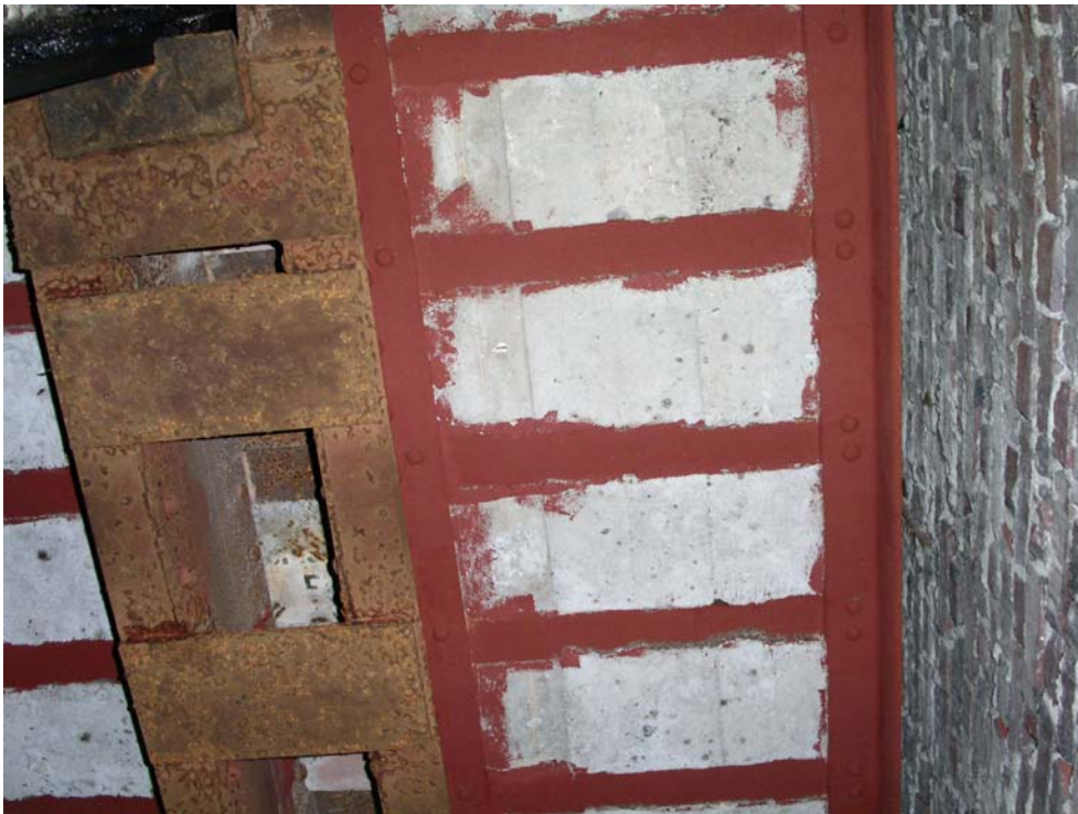
Bild 3: Korrodierte Stahlträger unter den Gegengewichten / Turm 1
