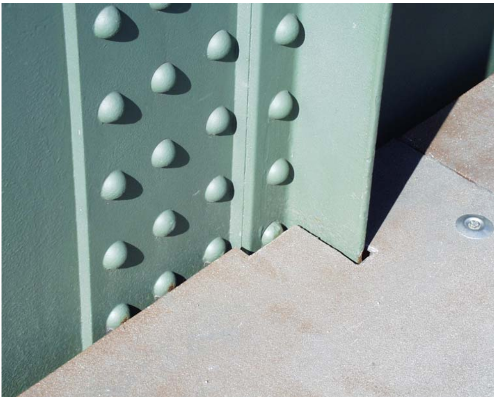
Bild 12: HT-Steblechstoß, Detail von Bild 11 (sehr guter Zustand der Nietköpfe)
