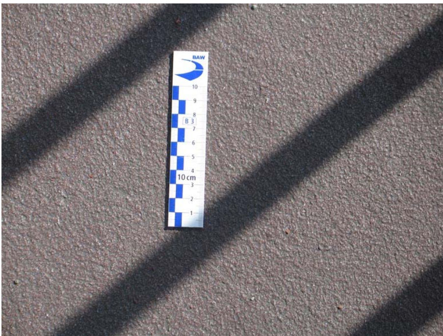
Bild 22: Gehwegplatte mit abgenutzter Oberfläche
