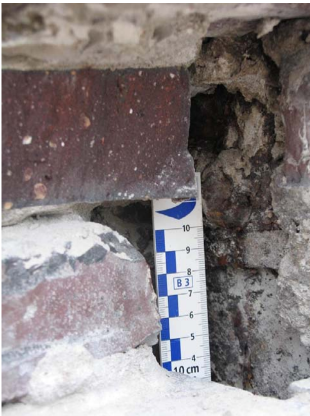
Bild 8: Rost am Träger und Bolzen vom Hubgerüst in Turm 2
