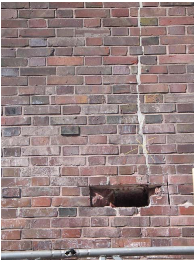
Bild 2: Detail Turm 4 mit Erkundungsöffnung im Rissbereich
