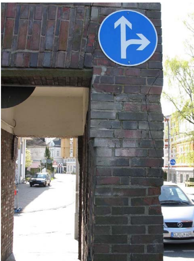
Bild 14: Anfahrtschaden am Durchgang von Turm 3
