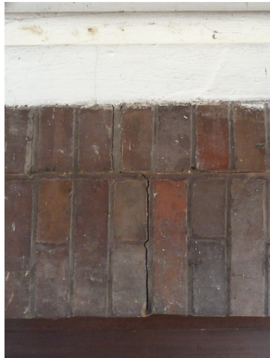
Bild 2-17 Turm 4 Riss im Türsturz
