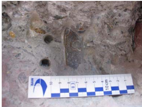
Bild 2-4 freigelegter Zugstab Turm 4
