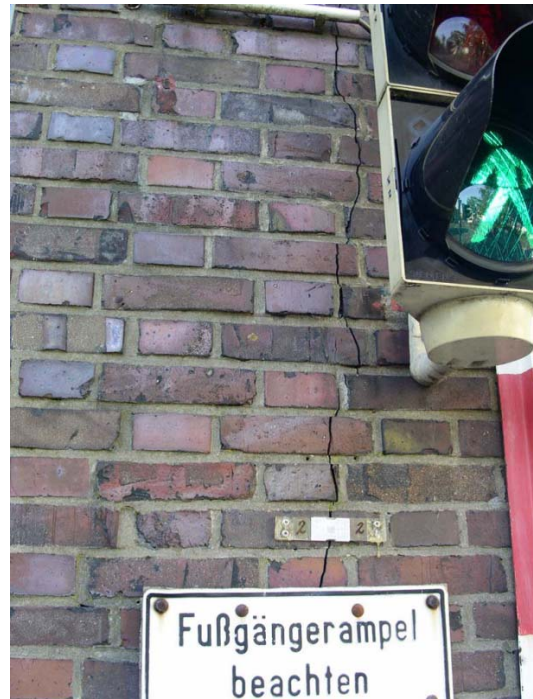
Bild 2-19 Turm 2 vertikaler Riss
