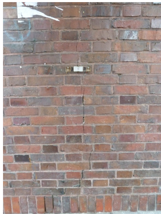
Bild 2-20 Risse in der Wandfläche
