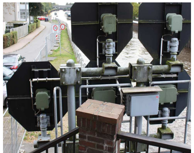
46 WSA Signale Rückseite IMG_1420.JPG
