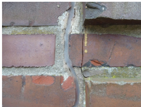
Bild 2-12 Rissfüllung mit dauerelastischem Material
