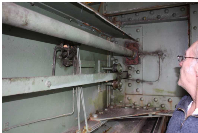
11 Detail Gleichlaufwelle und Schubgestänge Verriegelung IMG_1392.JPG
