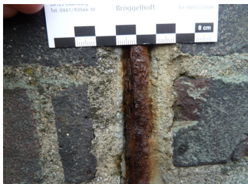
Bild 2-11 Korrosion Traggerüst im Mauerwerk
