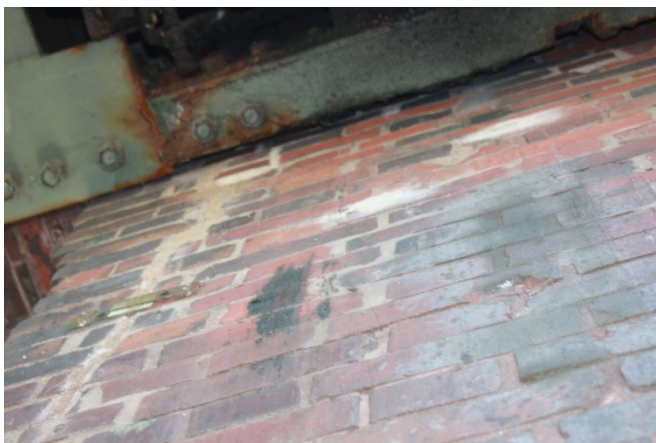
Bild 2-21 Mauerwerk Turm 3, Schleifspuren aus Fahrt der Hubbrücke zu erkennen
