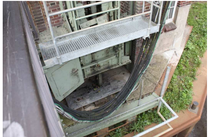
51 Leitungen Hiubbrücke Schaltschrankgebäude IMG_1380.JPG
