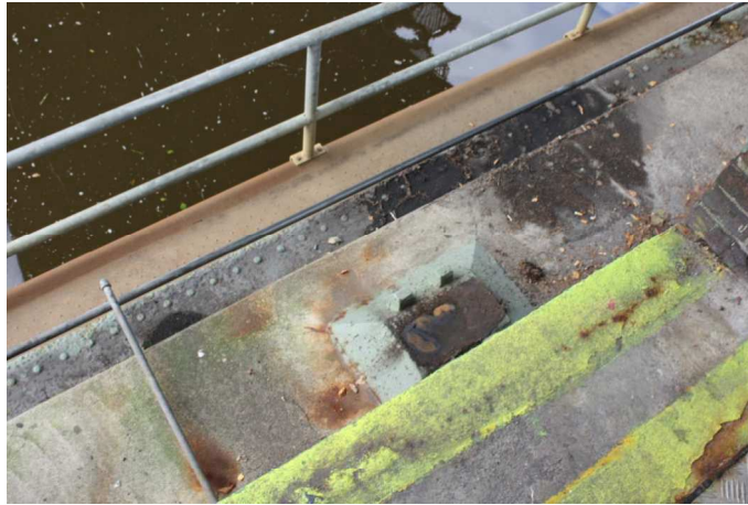
33 Auflagerbank mit Längszentrierung IMG_1412.JPG
