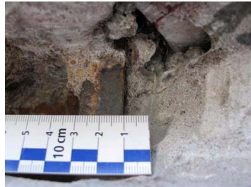
Bild 2-5 freigelegtes Stahlprofil Turm 2
