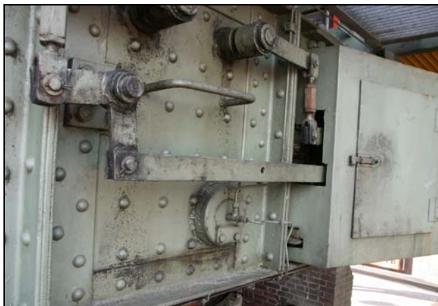
Abb. 3-5: Getriebestufe G5 Turm III außen
